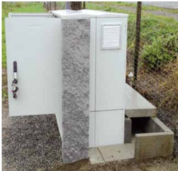
Bild 6. Installation in Wolpertswende
